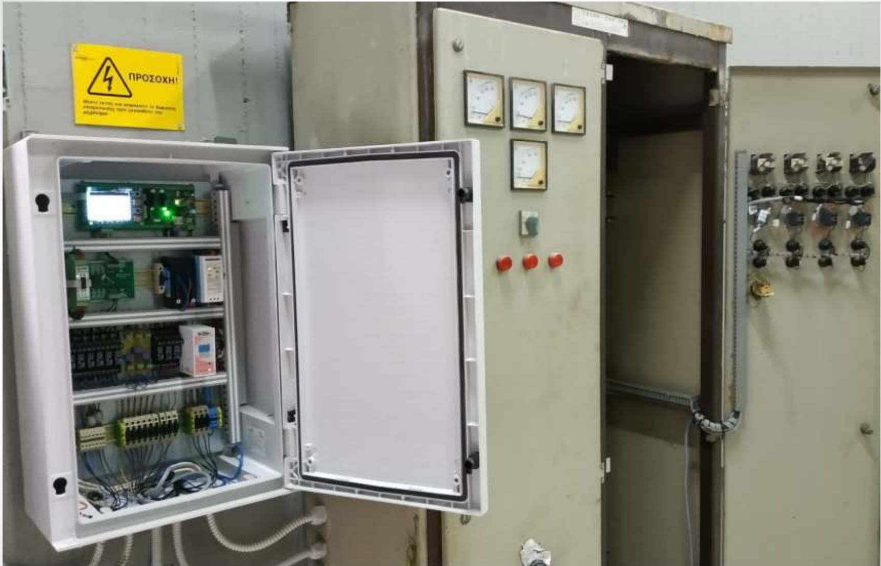
Εγκατάσταση σε παλιό αντλιοστάσιο 30ετίας (Αγ. Κωνσταντίνου, Τρίκαλα)
